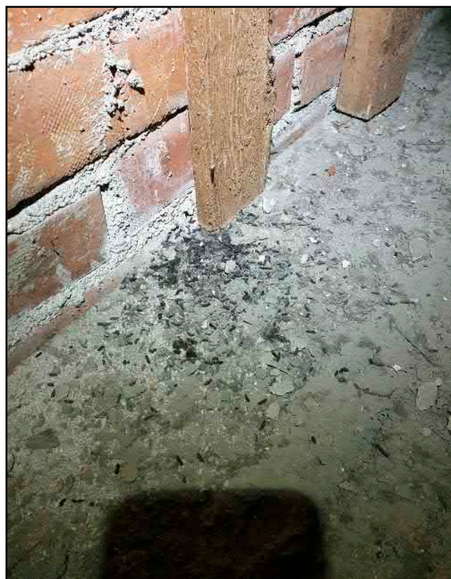
Länsiosan ulostetta tiiliseinän juurella.
