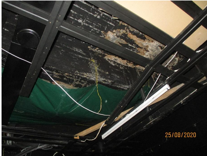
Kuva 5. Kattojen läpi on tullut irtovettä.
