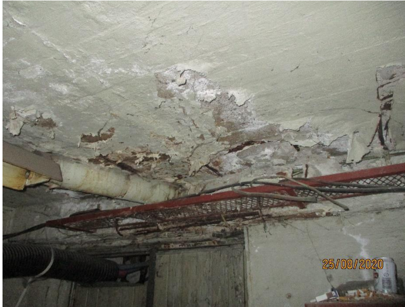
Kuva 1. Kellarin katon läpi on tullut vettä.
