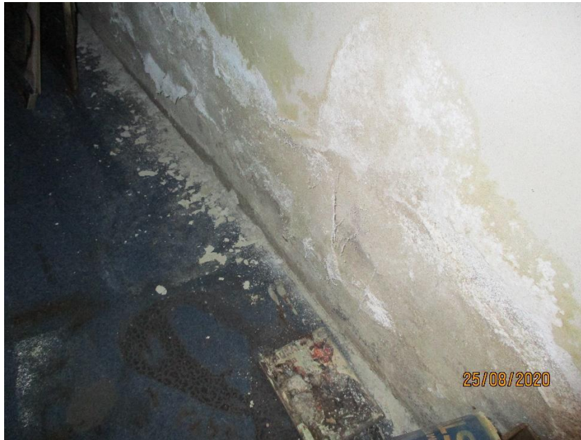
Kuva 3. Kellarissa on aistittavissa voimakas mikrobiperäinen haju.
