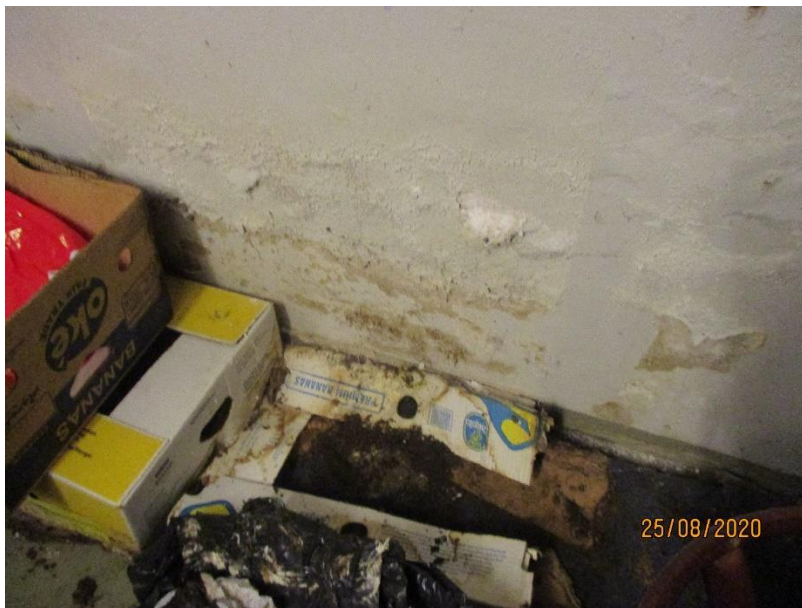
Kuva 2. Kellarin lattialla on ollut ilmeisesti irtovettä ja seiniin nousee maasta runsaasti kapillaarista kosteutta.
