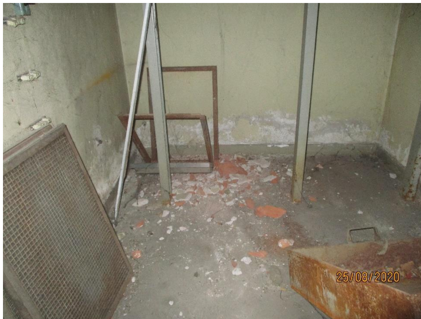
Kuva 4. Kellaritilat ovat todella huonossa kunnossa.
