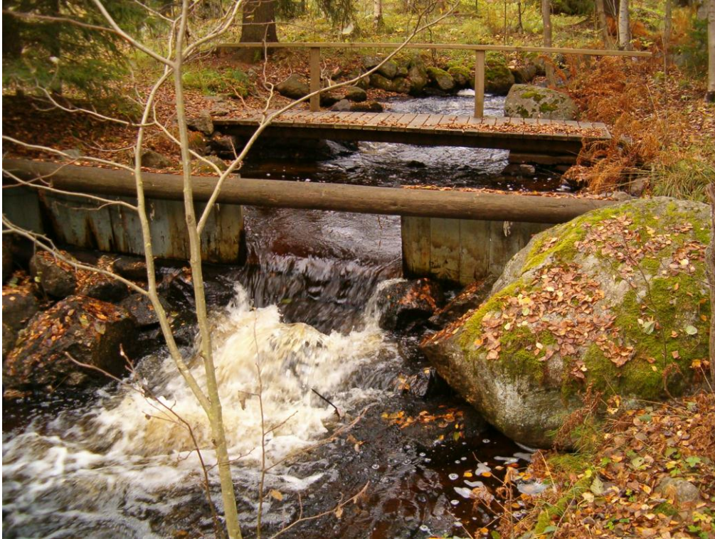
Kuva 2. Kohteen 3 paalulla 160 oleva patorakennelma. Pato tulisi korvata pohjapatojen ja kynnysten sarjalla kalan kulun mahdollistamiseksi.
