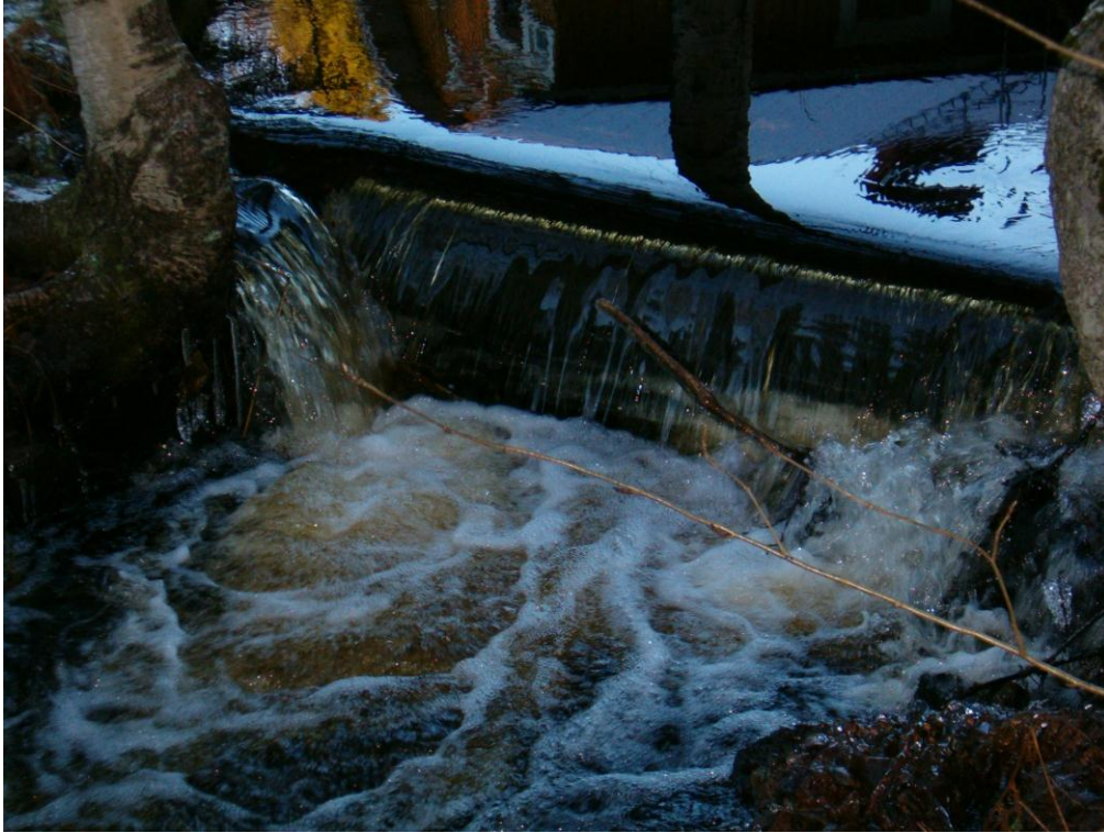
Kuva 4. Kohteen 3 ylempi pato. Pato tulee purkaa ja korvata pohjapatojen ja kynnysten yhdistelmällä.
