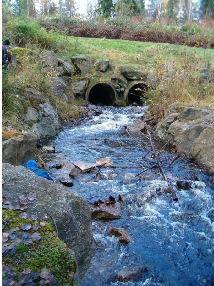
Kuva 14 Kohteen 5 paaluväli 140-160. Puro kulkee paaluvälillä louhitussa uudessa uomassa, joka ei vaadi toimenpiteitä
